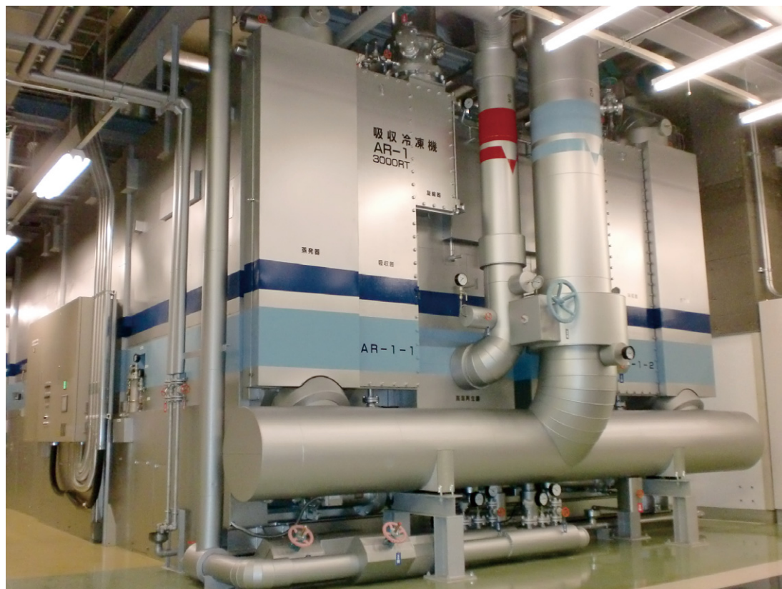
平成22年6月第2プラントに新設した3,000冷凍トン吸収冷凍機
