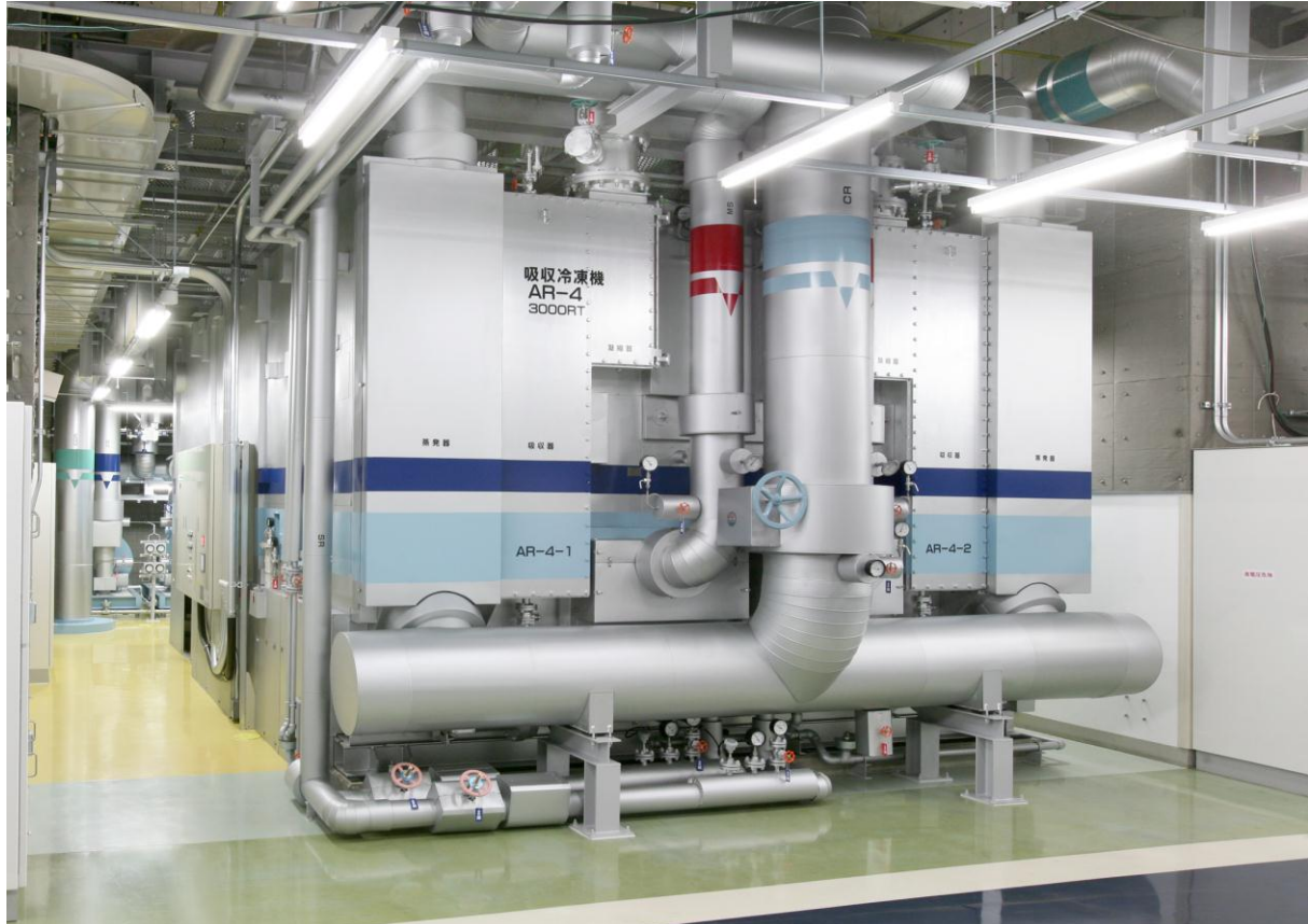
平成23年7月 第2プラントに新設した3,000冷凍トン吸収冷凍機
