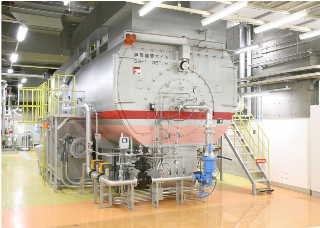
2010年12月 第2プラントに新設した 36 t/h の炉筒煙管ボイラー
