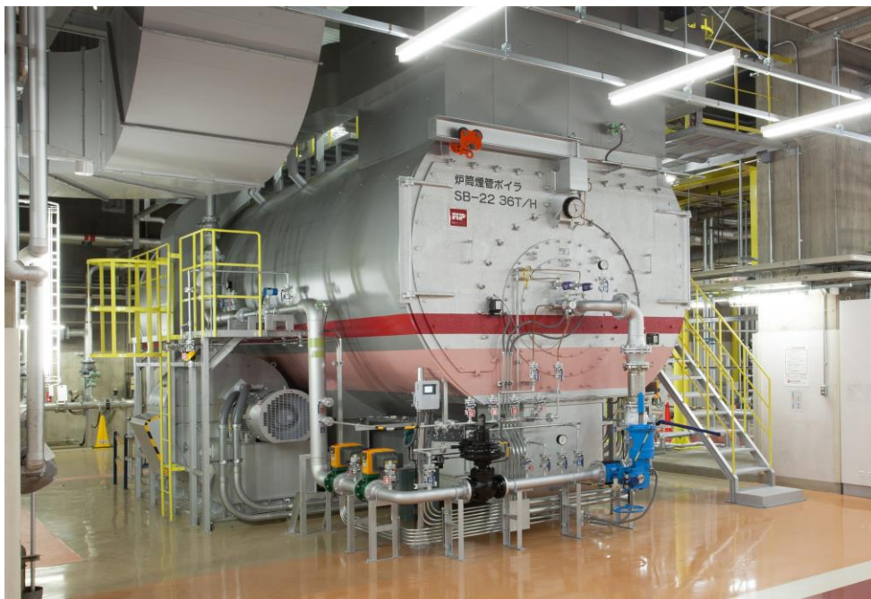
2014年9月 第2プラントに増設した36 t/hの炉筒煙管ボイラ
