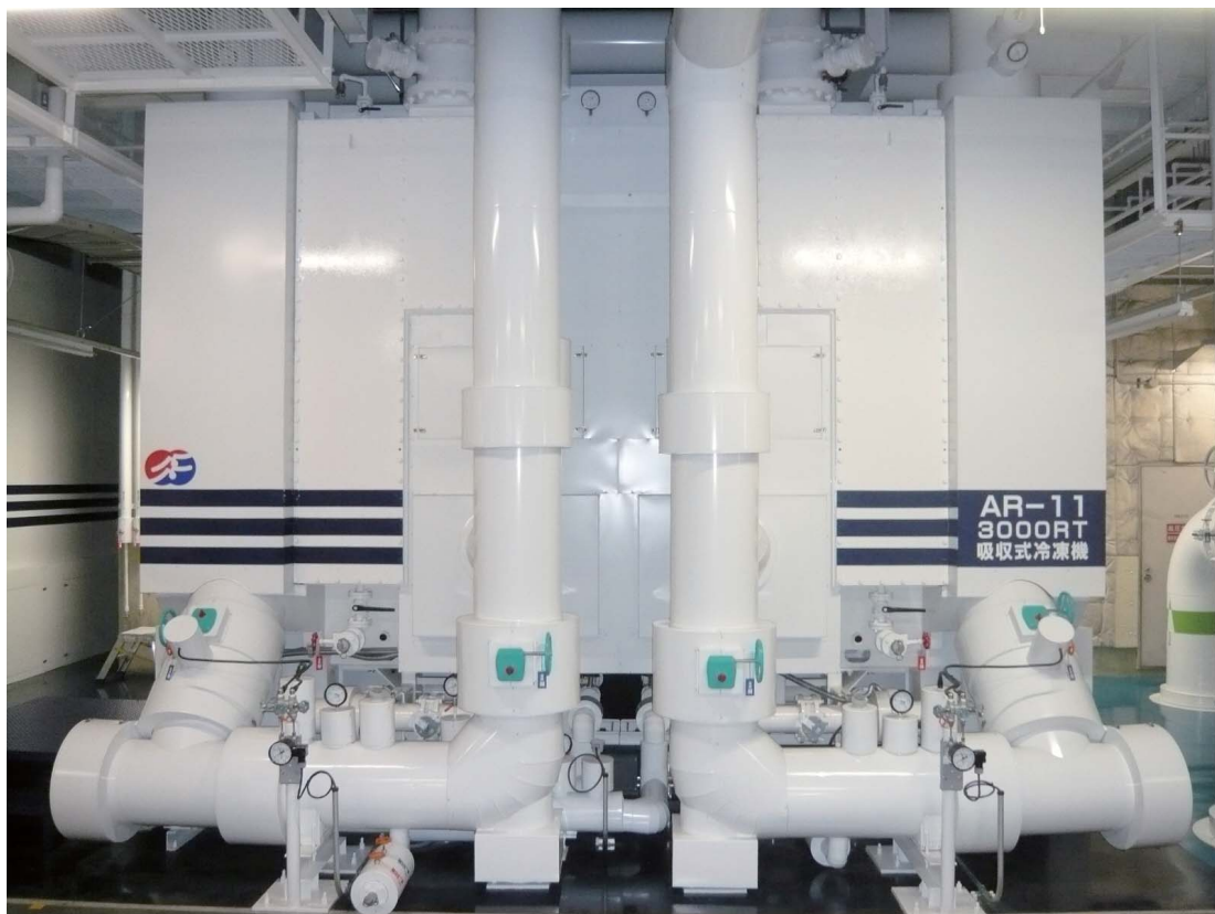
平成27年6月センタープラントに新設した3,000冷凍トン吸収冷凍機
