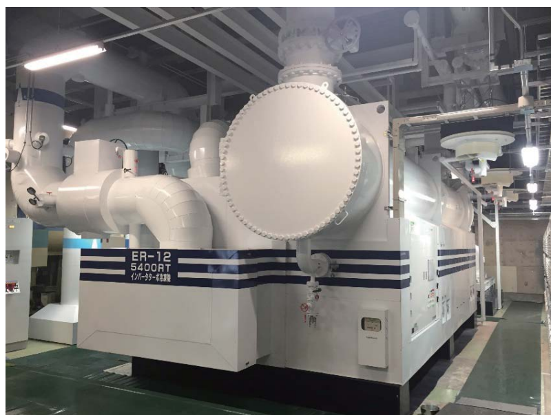
写真:今回設置した5,400 RT インバーターターボ冷凍機
